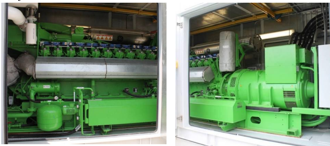
Слика 7.25. Пример контејнерског система мотора са унутрашњим сагоревањем спрегнутог са генератором електричне енергије – Jenbacher мотор снаге 1,4 MW (лево) и генератор прикључен на мотор (десно)
